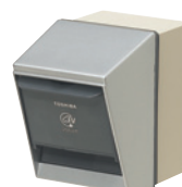
EV コンセント取り付け例
