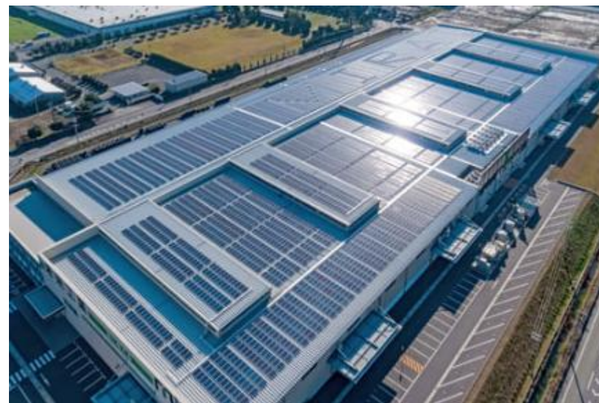
垂井工場(岐阜) 自家消費型メガソーラーを設置
